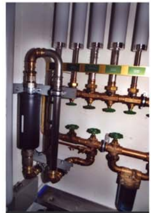
Bergstrasse Dietikon Verteilbatterie
