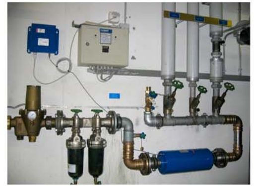
Grosswangen Altersheim nach dem Einbau des "Argnit" Systems
