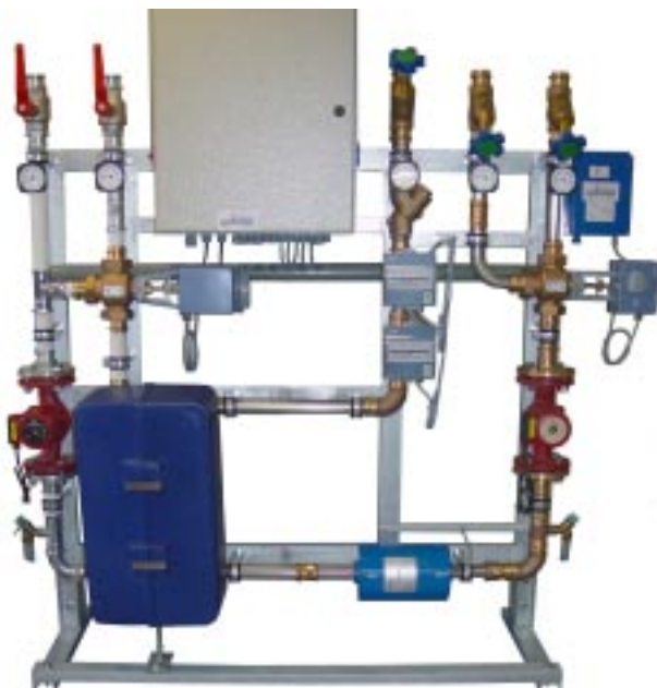
Ladestation LP2 mit integrierter physikalischer Wasserbehandlung
