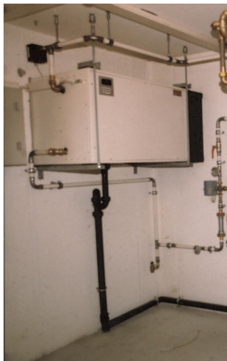
Abb: Die montierte Wärmepumpe
